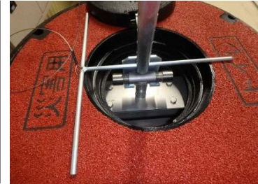
貯留弁の開状態
