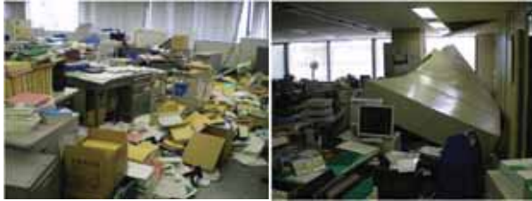
地震による民間ビル内 書庫転倒、書類散乱の状況
