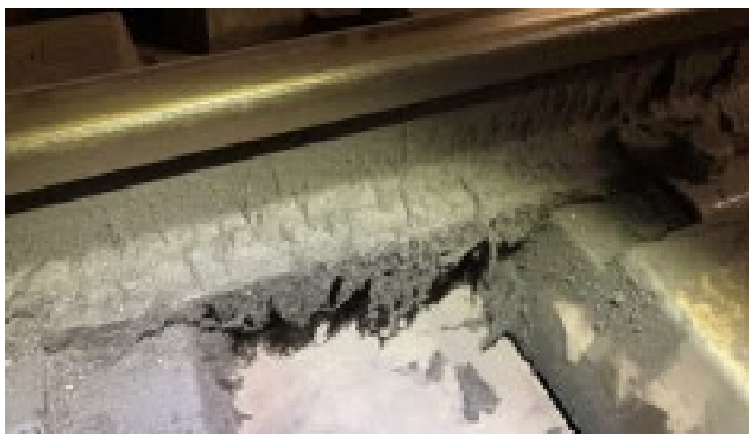
レール周辺の汚れ
