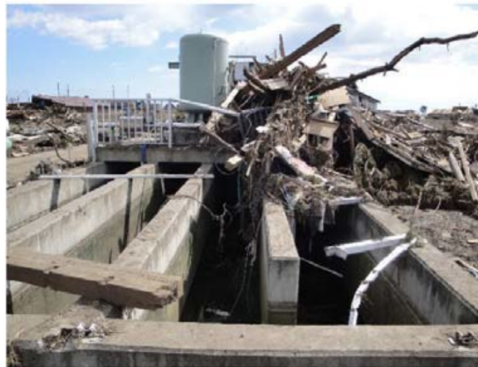
写真3. 津波被災事例
