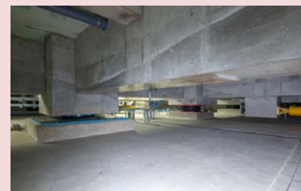
免震ピット（地下）
