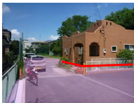
写真①【浸水の状況】 平成 26 年台風 18 号により、水路に隣接する学童保育所で浸水被害が発生。 (写真赤線位置まで水位が上昇)
