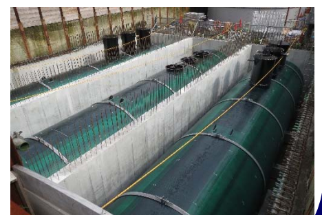
オイルタンク (9万ℓ×3基)
