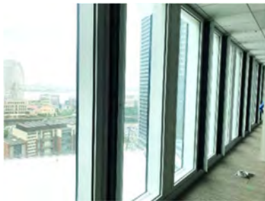
自然換気パネル
