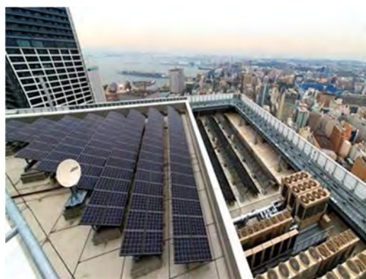
太陽光パネル
