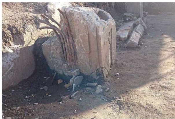
B 横浜貿易新報社新館（震災により倒壊）
