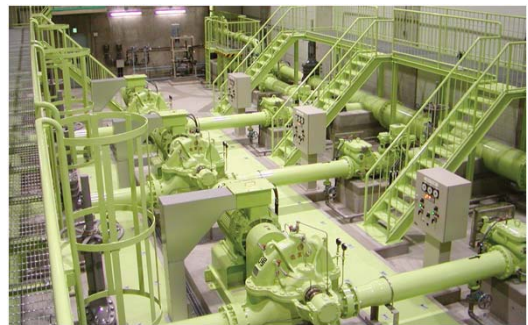
配水ポンプ(VVVF制御方式)
