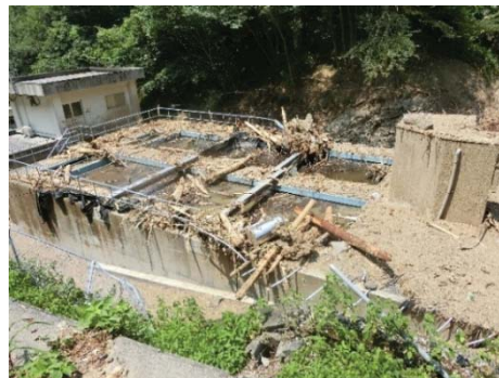
平成30年7月豪雨による浄水施設の被災状況（愛媛県宇和島市）
