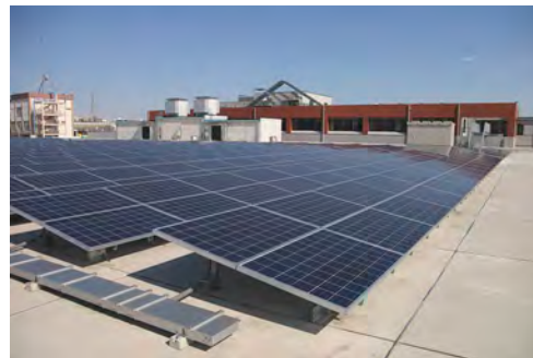
太陽光発電(川井浄水場)
