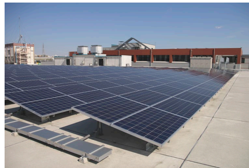
太陽光発電(川井浄水場)
