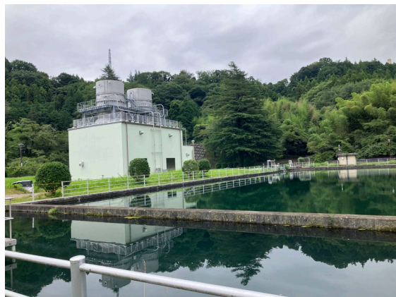
青山沈でん池 活性炭注入設備
