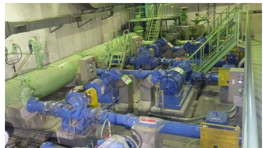
配水ポンプ(VVVF制御方式)
