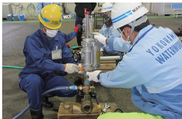
横浜市水道局と名古屋市上下水道局の技術交流会の様子
