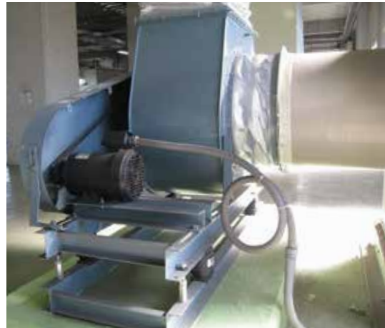
高効率モータ使用機器(送排風機)
