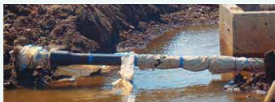
東日本大震災の津波にも耐えた耐震管 (H23年仙台市水道局提供)
