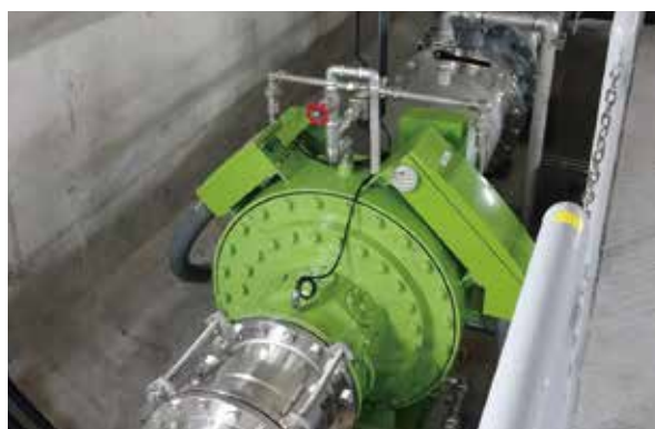
小水力発電設備(今井配水池)
