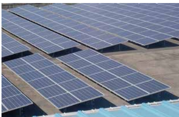
太陽光発電設備(川井浄水場)
