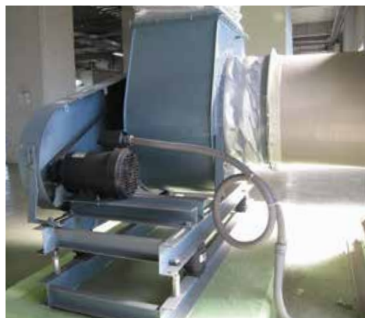
高効率モータ使用機器(送排風機)
