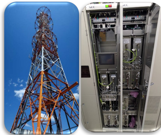
《電波塔/無線装置本体》
