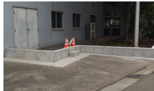
浸水対策(止水壁設置)事例
