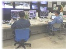
焼却工場管制室の様子
