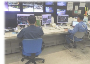
焼却工場管制室の様子
