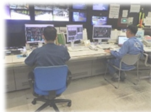
焼却工場管制室の様子
