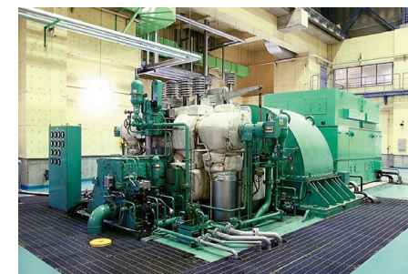
改修を予定する蒸気タービン
