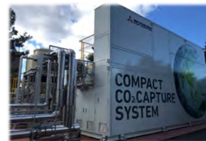
焼却工場のCO 2 回収の実証試験
