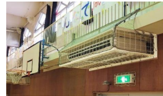
体育館空調設備
