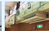
体育館空調設備
