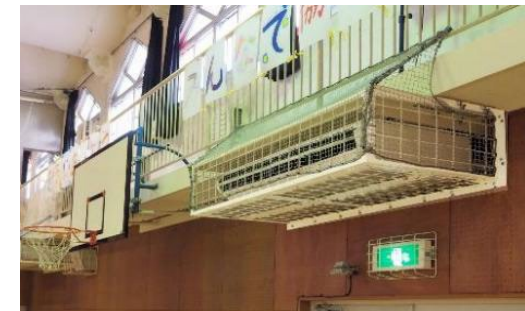
体育館空調設備
