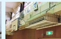
体育館空調設備
