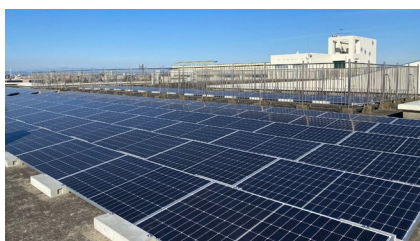
太陽光発電設備
