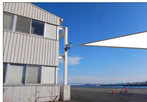
【上屋に設置した管理用カメラ】
