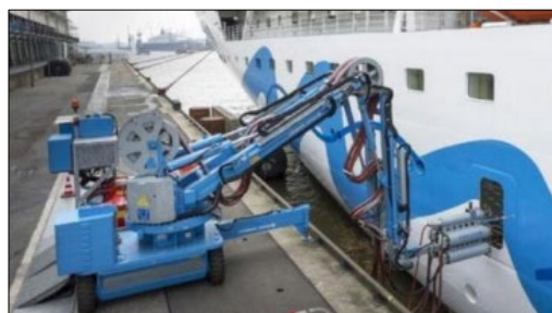
【ハンブルク港におけるクルーズ船への陸上電力供給の様子】
