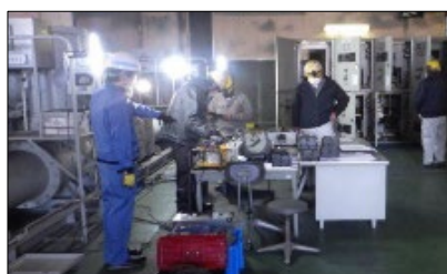
【本牧D突堤年次点検（電気設備動作確認）】
