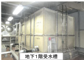
地下1階受水槽
