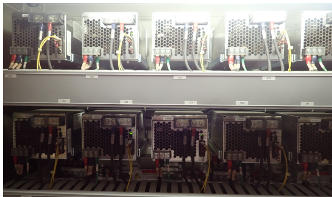
回生電力貯蔵装置(電源ユニット)
