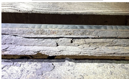
腐食したサードレール
