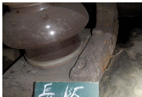
腐食した腕金
