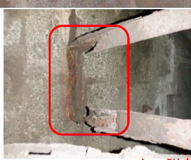
アンカー脱落
