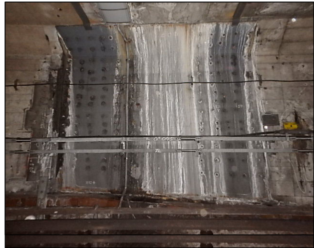
▲関内・長者町ケーソン耐震鋼板 下り
