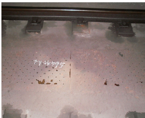
排水溝蓋(アンチスリップ鋼板)
