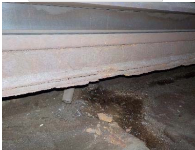
腐食したサードレール
