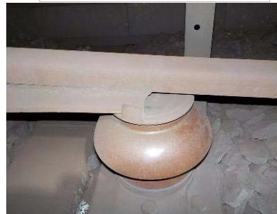
ふく進によりずれたエンドアプロー
