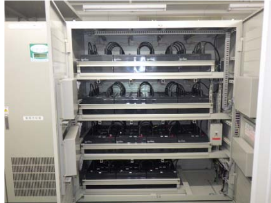
鉛蓄電池設置状況
