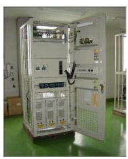
【参考】直流電源装置
