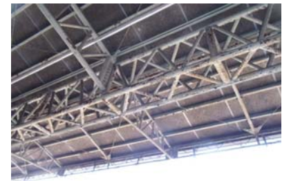
工場鉄部塗装錆状況
