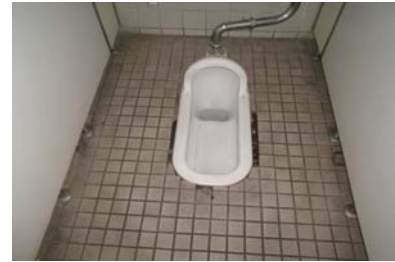
男子トイレ床タイル剥がれ
