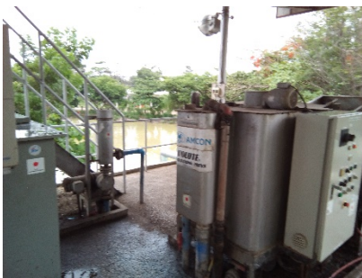
市内企業により JICA 中小企業普及実証事業で設置された汚泥脱水装置の様子。
