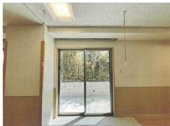
5. 重心型避難口（外通路側）
