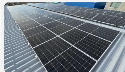
太陽光発電設備
