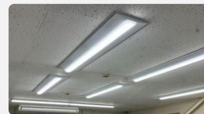
LED照明設備
