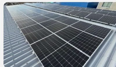
太陽光発電設備
