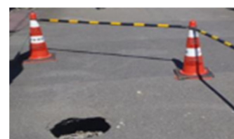
取付管破損による道路陥没
