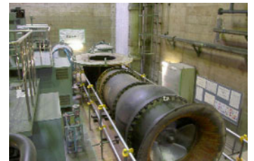
汚水ポンプの長寿命化
