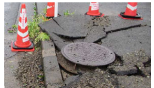
マンホール浮上被害状況
