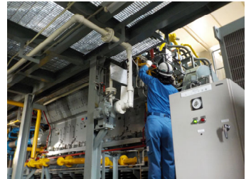
自家発電設備の維持管理
