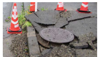
マンホール浮上被害状況
