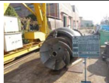
ポンプの主要部品の交換
