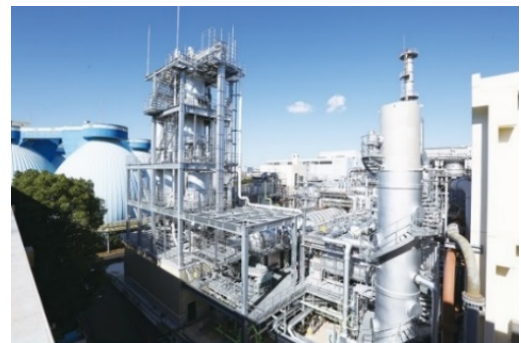
南部汚泥資源化センター燃料化施設
