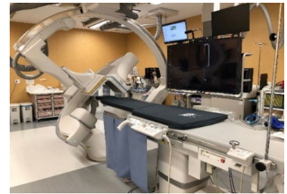
<市民病院の血管撮影室>
