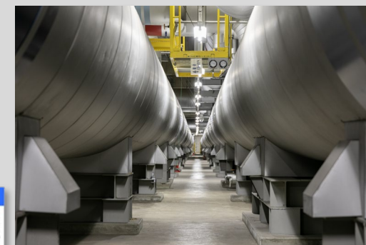
熱を供給するための導管
