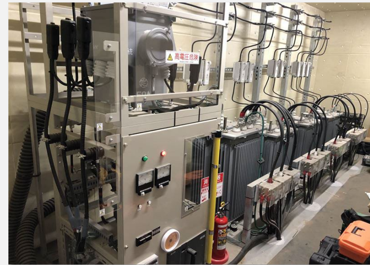
設置された高圧一括受電の受変電設備
