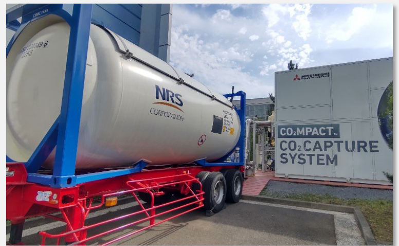
ごみ焼却工場におけるCO 2 回収実証
