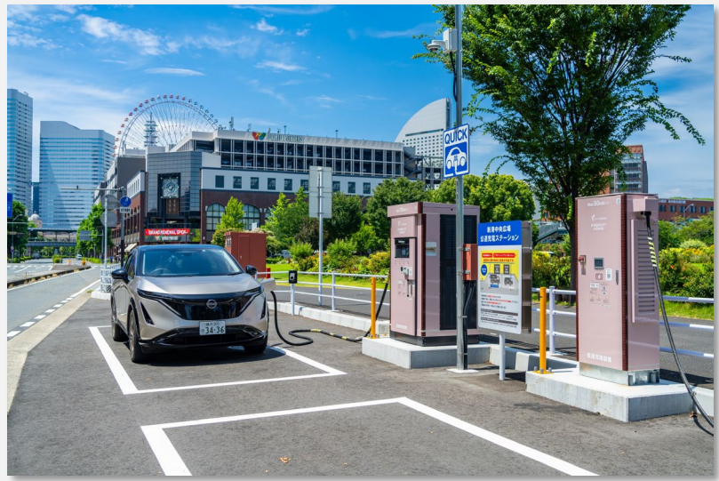
中区新港中央広場公道充電ステーション
