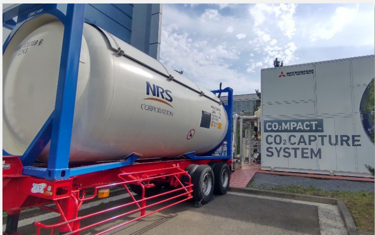
ごみ焼却工場におけるCO 2 回収実証
