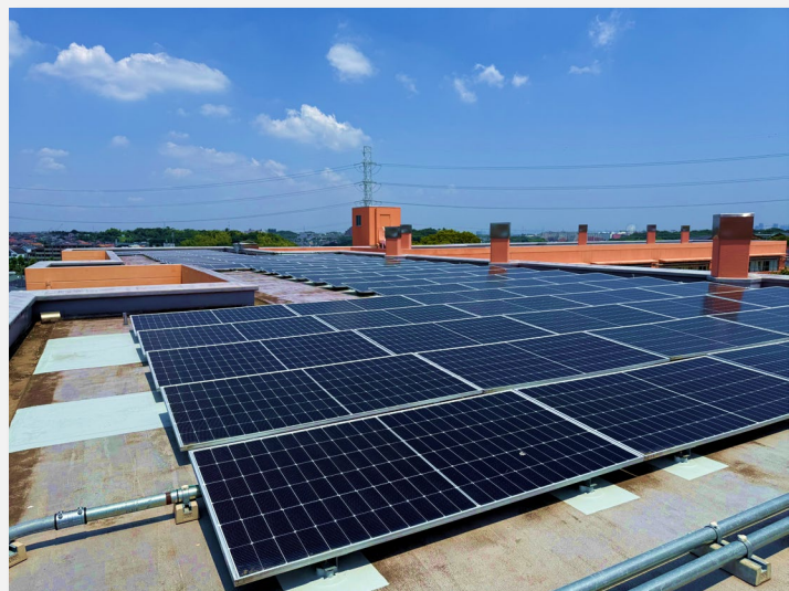
PPA事業で市立学校に導入した太陽光発電設備
