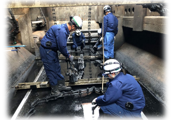
最初沈殿池設備
