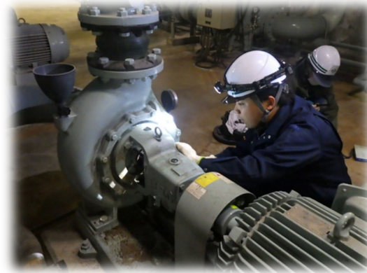
汚泥ポンプ設備
