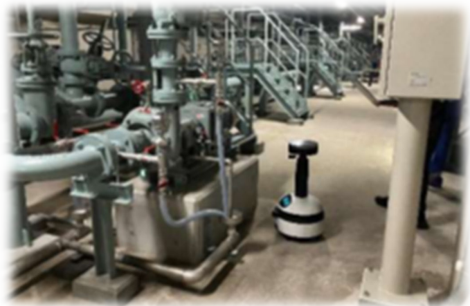
AGVでの自動巡回点検実験の様子
