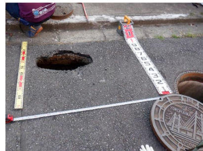
取付管破損による道路陥没
