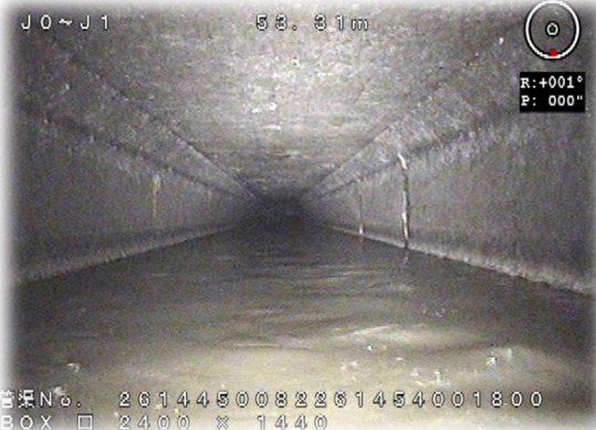
下水道管内の状況(腐食の一例)
