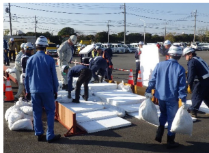
◀道路啓開合同訓練（段差の解消訓練）▶ 横浜建設業協会（金沢区会）・金沢土木事務所
