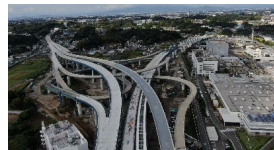
横浜環状南線・横浜湘南道路 (高架橋整備：(仮)栄IC・JCT)
