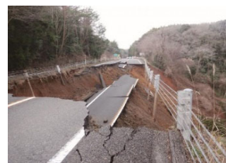
令和6年能登半島地震の道路被害 のと里山海道 (石川県ホームページから)
