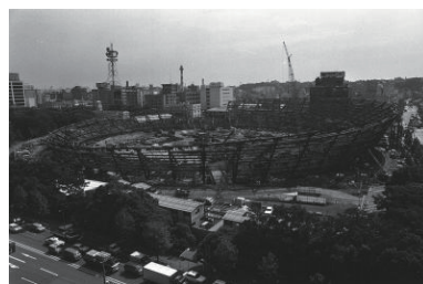
市庁舎屋上からの眺望、横浜スタジアム工事中(中区) 1977年09月12日 6926
