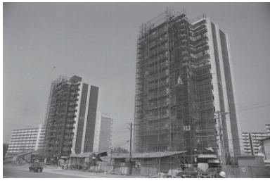
金沢地先埋立地に高層住宅建設(並木団地) (金沢区) 1978年04月10日 7419
