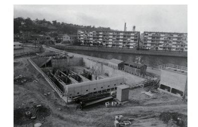
中部下水処理場、後方小港団地(中区) 1962年05月 1274
